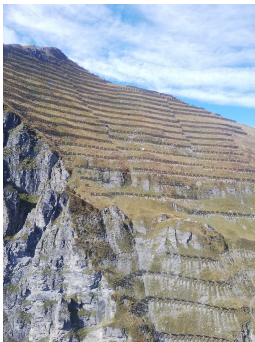
Anbruchverbauung Hintertux-Lawine (Quelle: WLW)
