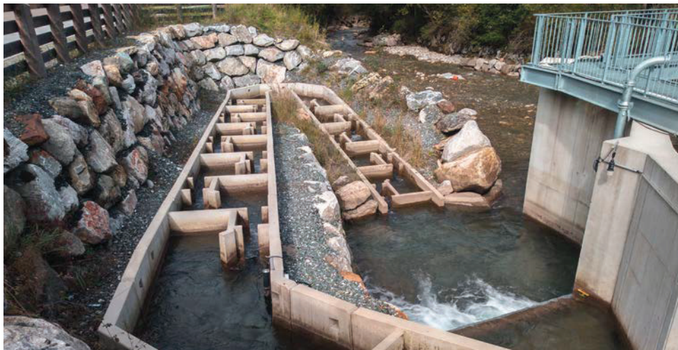
Beispiel: Technische Fischwanderhilfe in Form eines „Vertical Slot Fish Pass“ beim Kraftwerk Hermann & Müller KW an der Fuscher Ache
