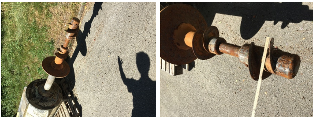
Abbildung 113 Aus dem Faulturm des Abwasserverbands AIZ ausgebauter Impeller mit Abrasionen und Verschleiß am Impellerblatt.
