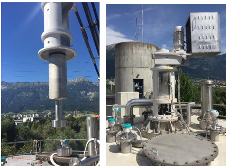
Abbildung 109 Darstellung des Einbaus des Propellerührwerks vom Typ „Scaba“ (links) und des Faulturmdeckels (rechts) nach dem Umbau der Faultürme der Kläranlage Innsbruck.
