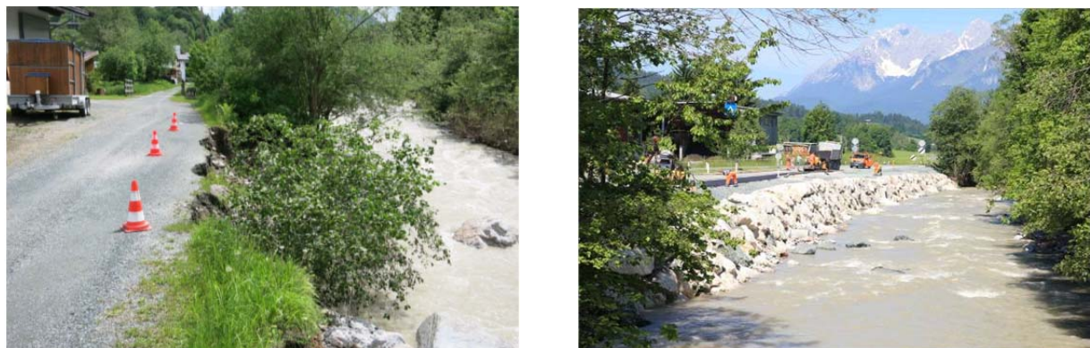
Abbildung 7-30: Links: Fkm 12.70; Uferanrisse rechtsufrig (Quelle: Amt der Tiroler Landesregierung); Rechts: Uferanriss und Zerstörung der Ufer-sicherung auf 100 Ifm (Quelle: IWHW)
