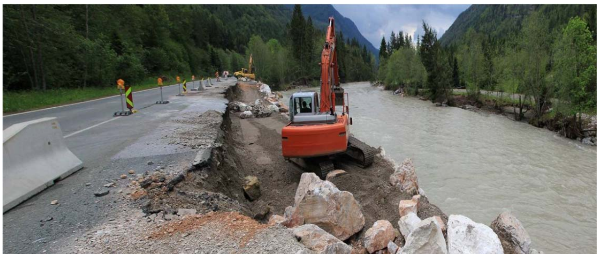
Abbildung 7-24: Komplette Zerstörung des linken Ufers bei Fkm 8.80 (Quelle: Amt der Tiroler Landesregierung)
