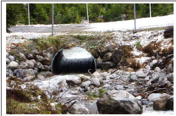
Abb. A4: Verrohrung bei Wegquerung (Foto: Richild Mauthner-Weber, BMLFUW)
