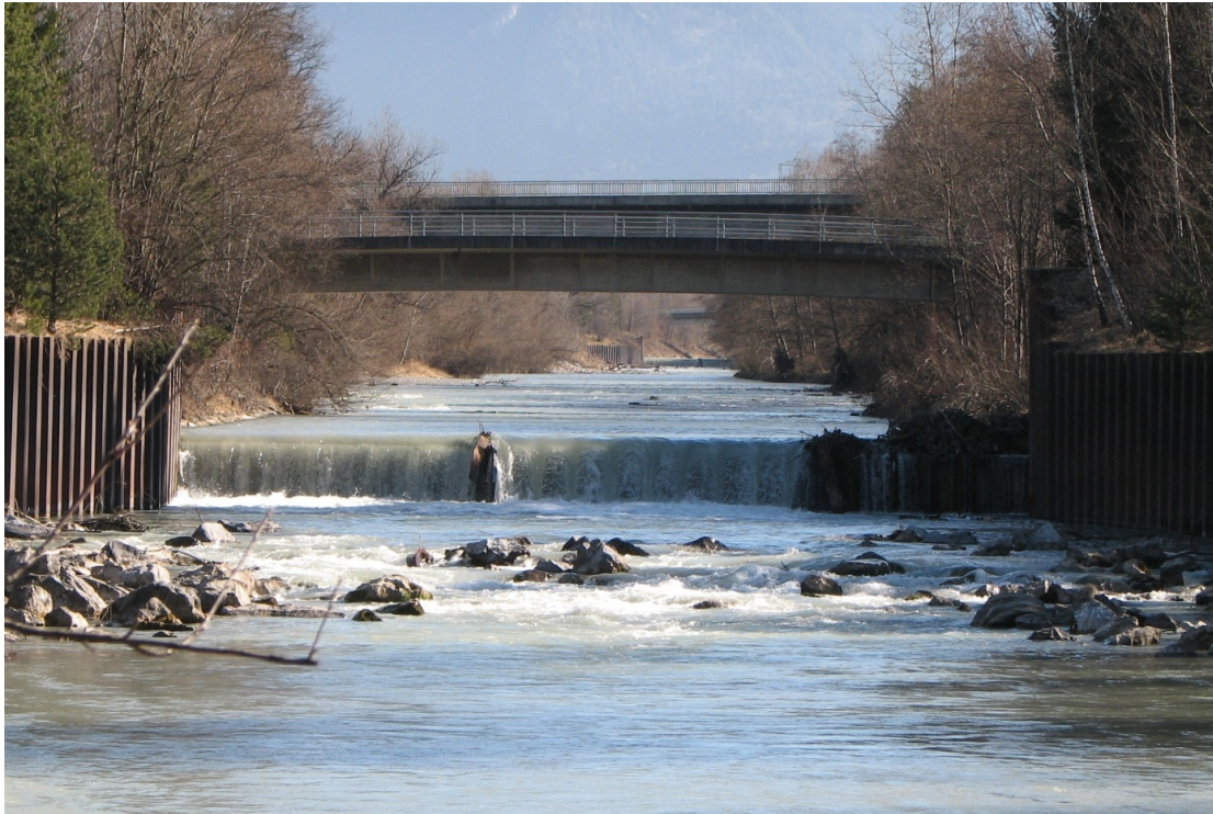
Abb. 1: Sohlabstürze in der Ill in Nüziders vor deren Umbau (Alban Lunardon)
