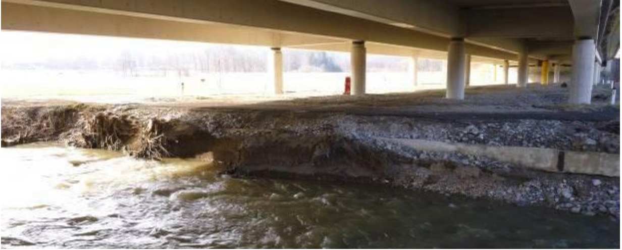
Abbildung 12: Uferschäden bei der Autobahnbrücke PY29. (© Gewässerbezirk Linz)
