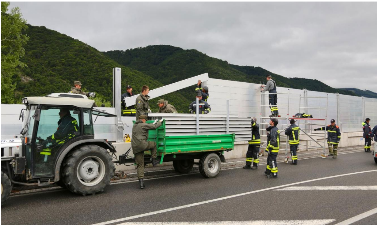
Abbildung 19: Mobiler Hochwasserschutz in Weißenkirchen. (© wachaufoto.at)
