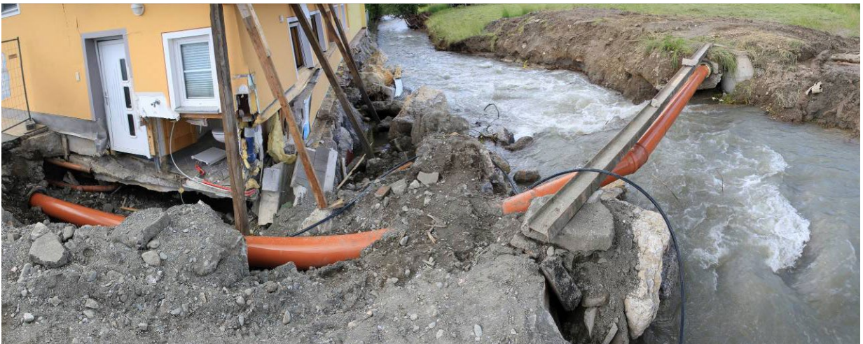
Abbildung 14: Beschädigung eines Fundamentes. (© IWHW)
